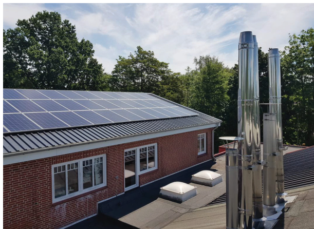
Solceller på taget leverer strøm til bageriet
